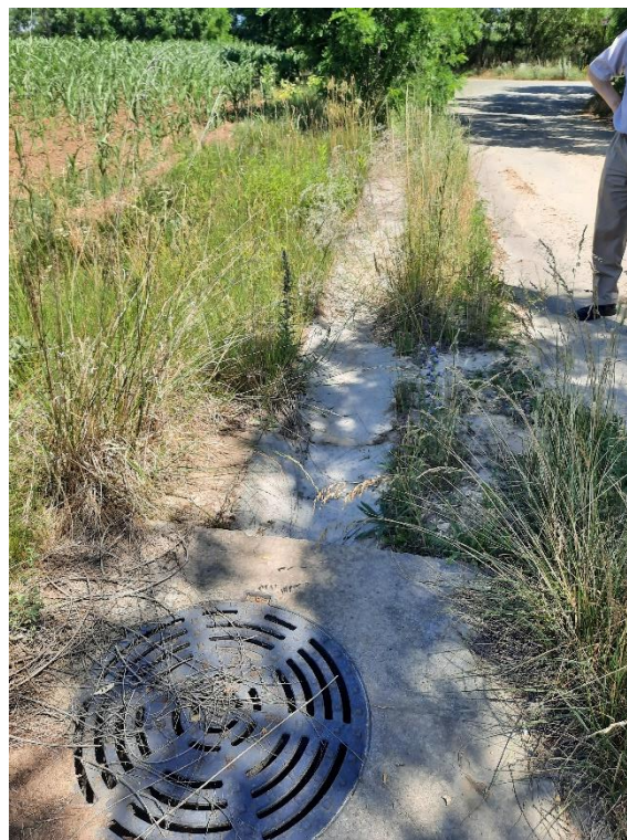
36. Jelenleg működésképtelen padkafolyóka
